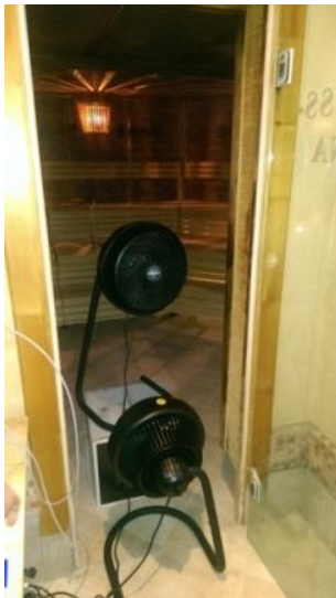
Abbildung 8: Leistungsstarke Spezialventilatoren zur Lüftung der Saunaräume (unten Zuluft in den Saunaraum, oben Abluft aus dem Saunaraum)
