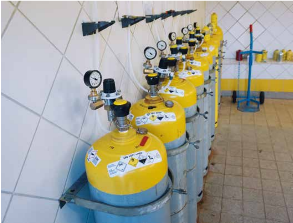
Lagerung von Chlor im Chlorgasraum eines Schwimmbades
