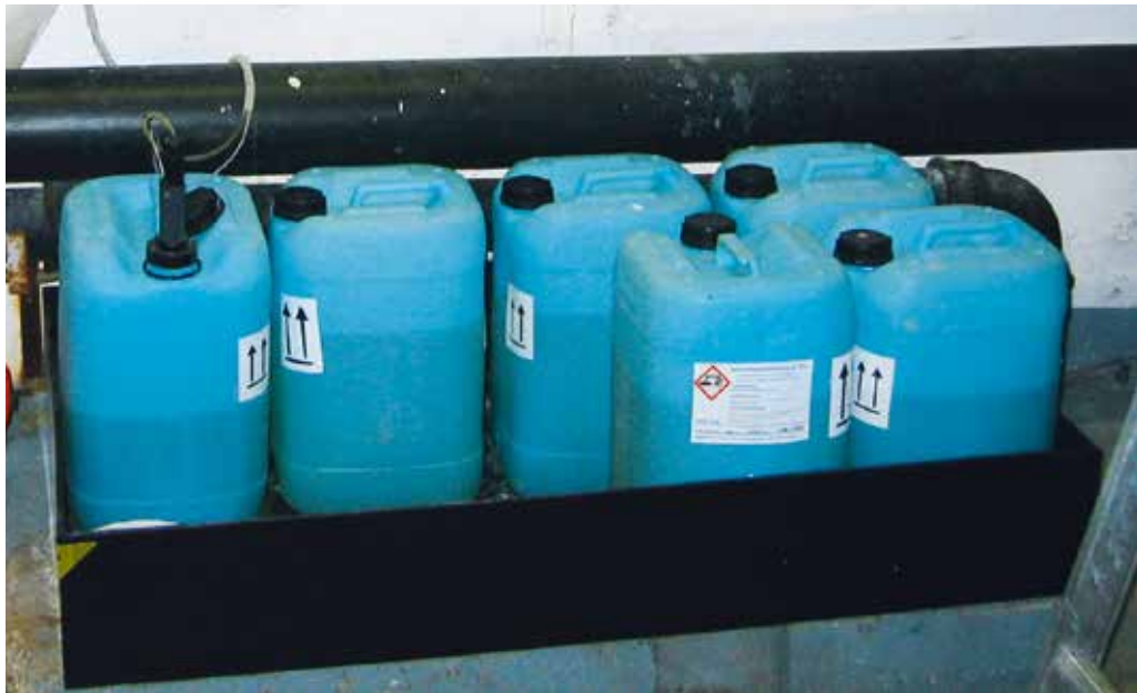
Behälter mit Natriumhypochlorit-Lösung in einem Schwimmbad
